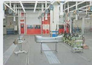
●板金塗装ブース
